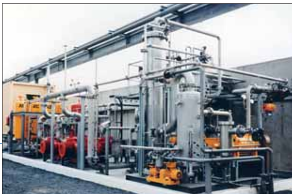
Anlage zur Benzindampfrückgewinnung an einem Tanklager der Aluminium Rheinfelden GmbH, heute Borsig MT.
